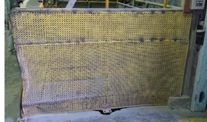
【修理前の安全柵】
